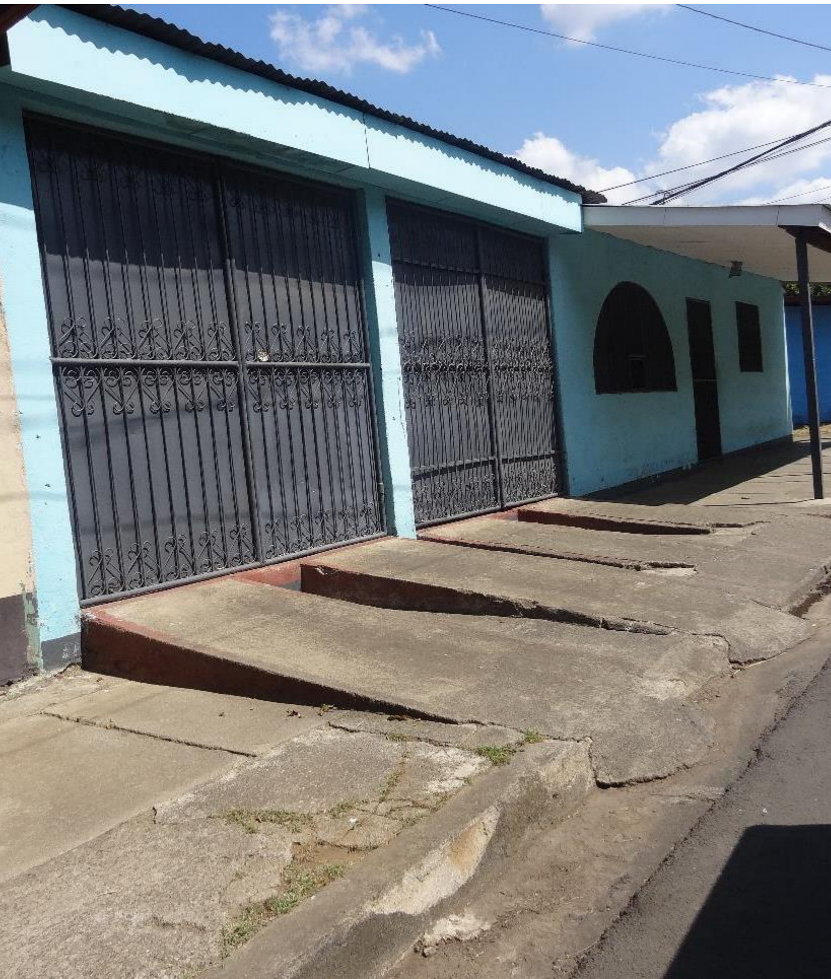
POR CONSTRUCCION DE RAMPAS QUE SOBRE PASAN EL NIVEL DE ANDEN
