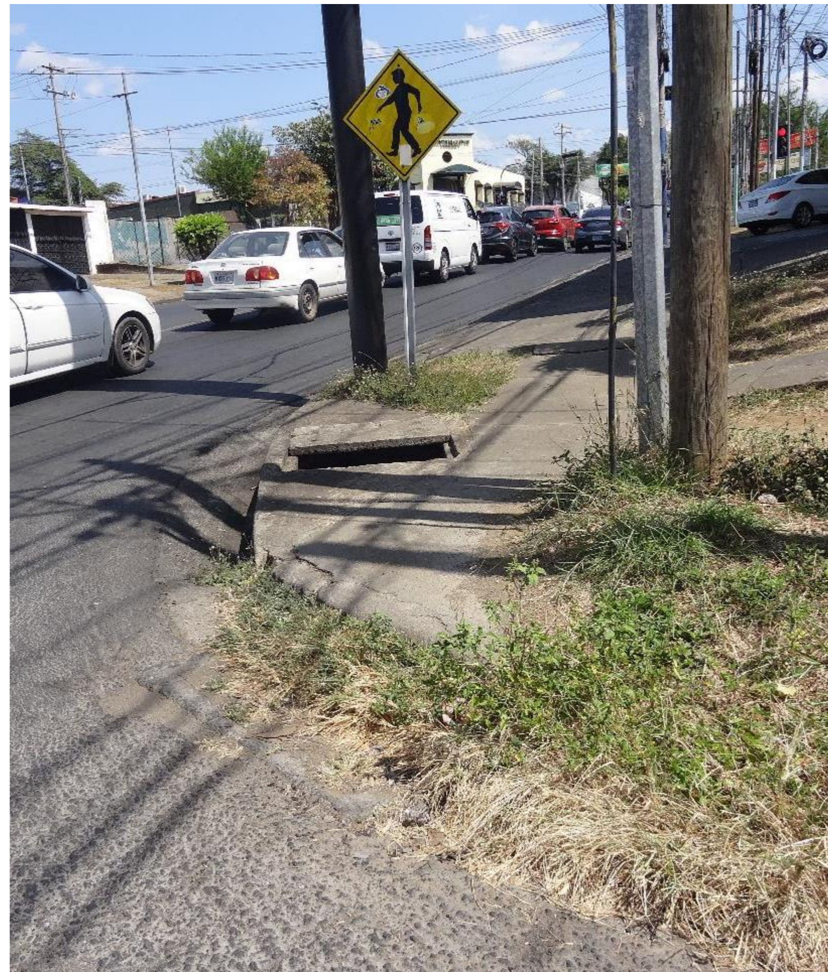
POR TRAGANTES PLUVIALES SIN TAPADERA
